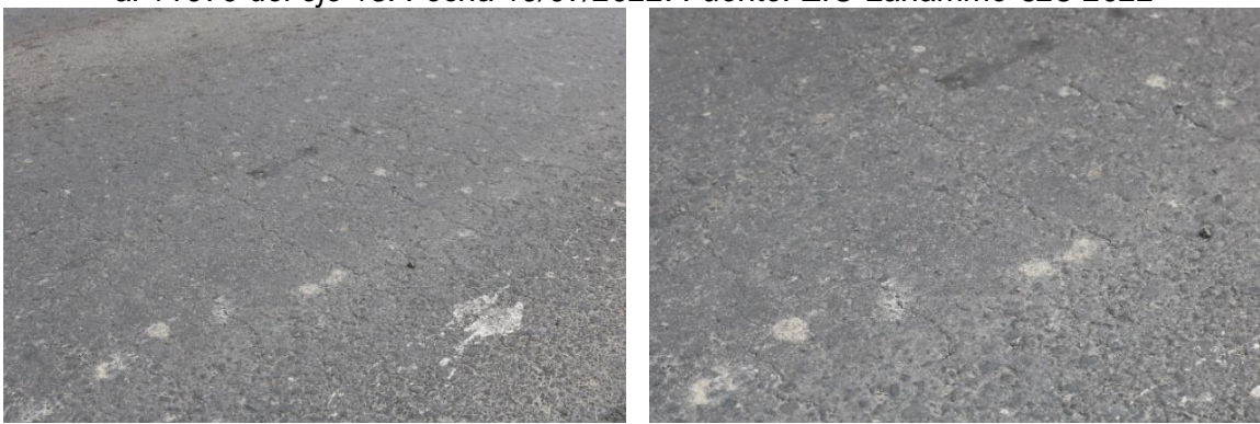
Figura 13. Agrietamiento en capa de mezcla asfáltica, entre los estacionamientos 0+780 al 1+070 del eje 15. Fecha 19/07/2022. Fuente: EIC-Lanamme-628-2022
