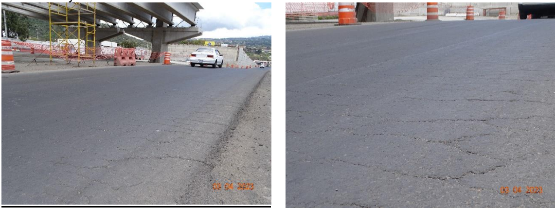
Figura 14. Agrietamiento en capa de mezcla asfáltica, entre los estacionamientos 0+780 al 1+070 del eje 15. Fecha 03/04/2023. Fuente: Unidad de Auditoría Técnica.
