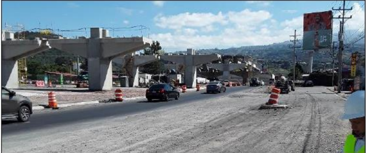
Figura 23. Separación no uniforme entre dispositivos de control de tránsito, cercanías “Top Outlet”, Cartago
