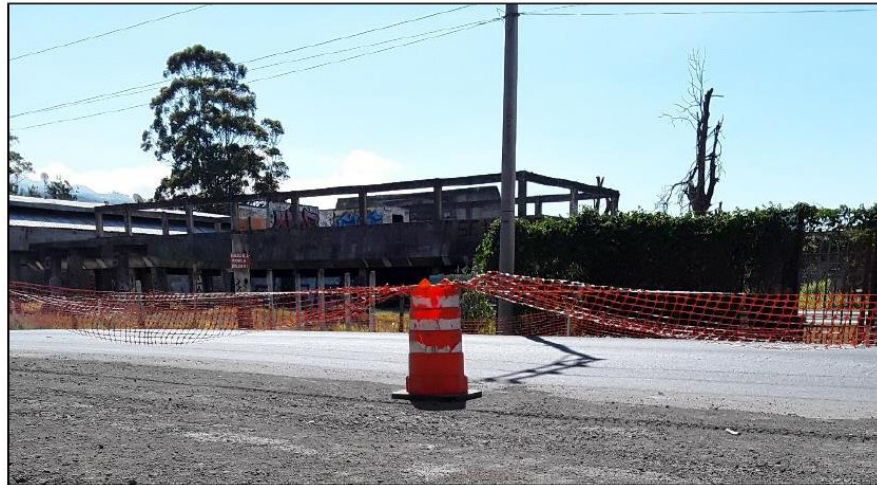
Figura 24. Barril en mal estado junto con utilización de malla que no se encuentra dentro de los dispositivos uniformes para el control del tránsito, cercanías “Top Outlet”, Cartago
