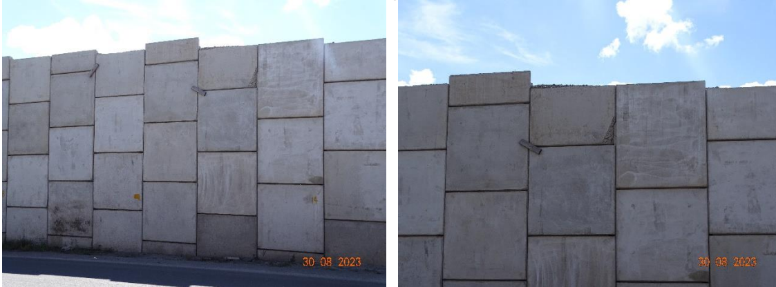
Figura 20. Escamas dañadas del muro del paso a desnivel de Avenida 23
