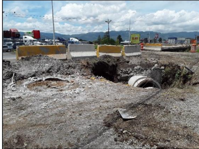
Figura 22. Barreras de concreto discontinuas, sin vinculación entre sí y sin anclaje apropiado para contener un vehículo, colocadas en los bordes de las zonas de excavación.
