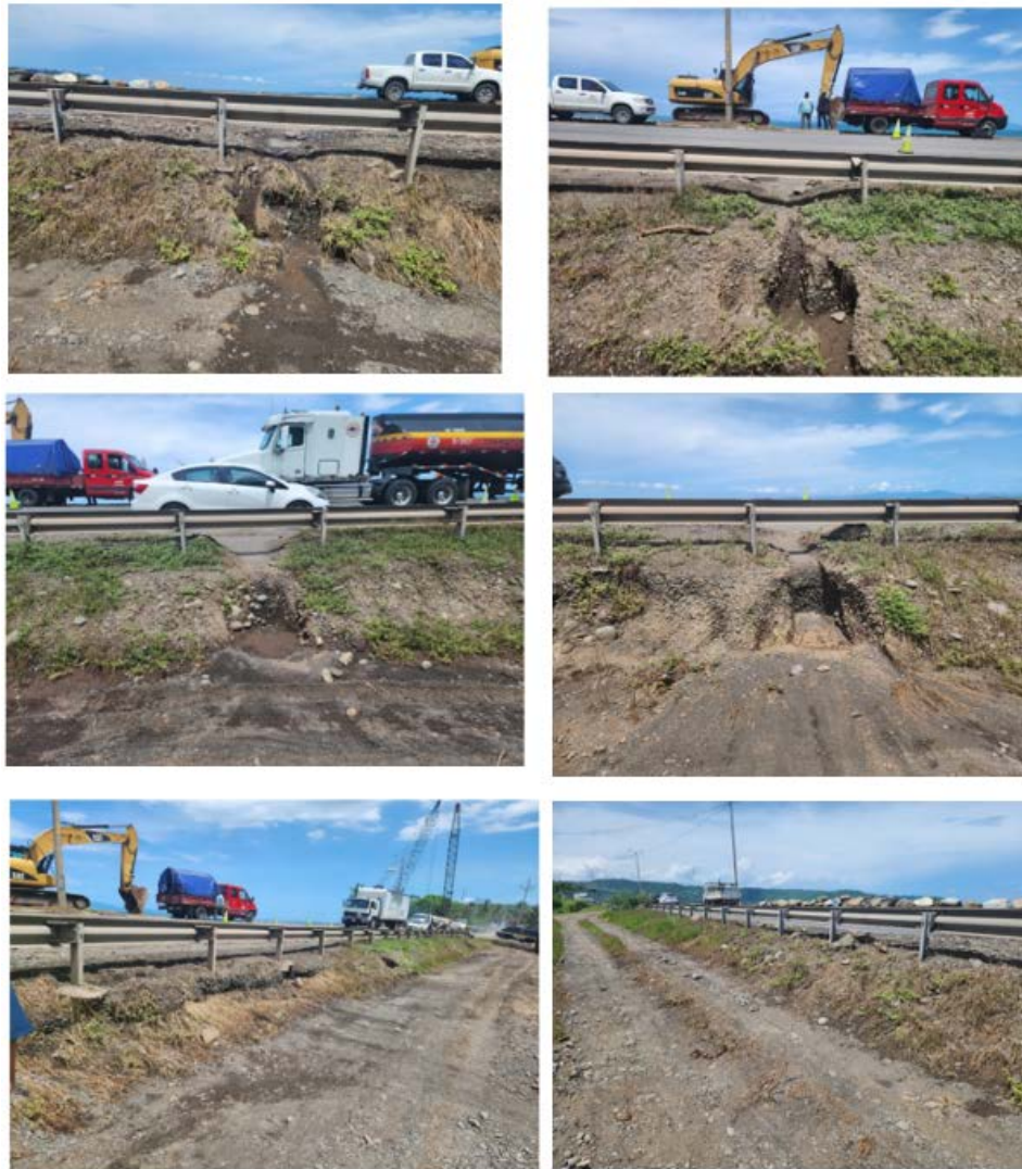
Figura 29. Diferencia del nivel entre la rasante y la vía marginal, así como, erosión en los rellenos en la Ruta Nacional N°-23 en el sector de Caldera
