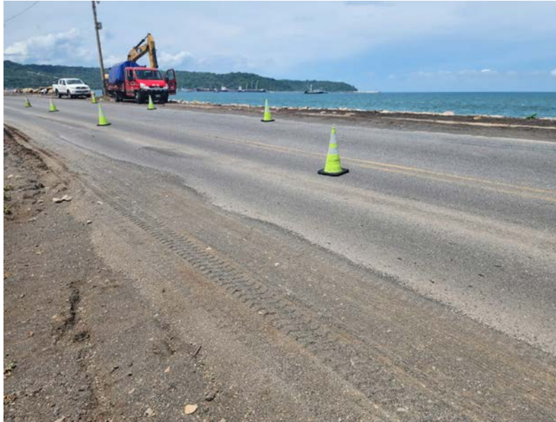
Figura 28. Presencia de arena en la RN-23 en el sector de Caldera
