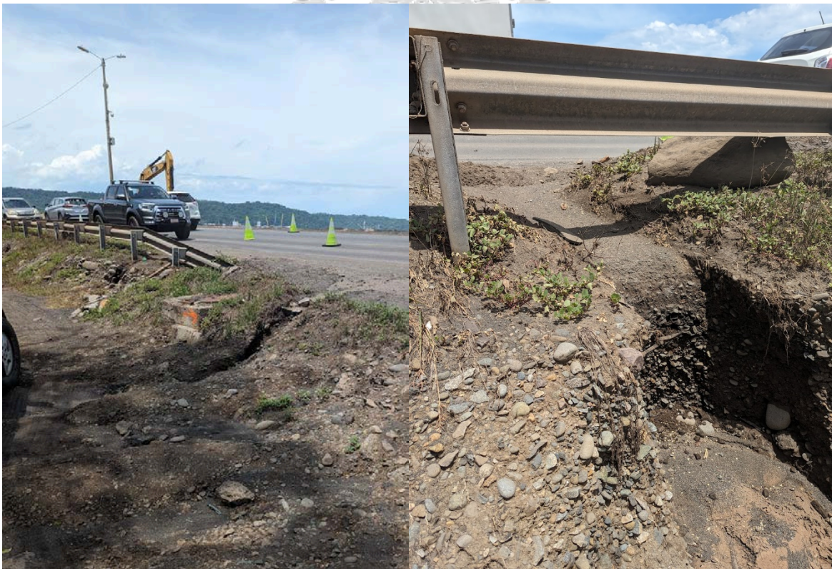
Figura 32. Cárcavas generadas por flujos de agua superficial no controlados sobre el relleno de la Ruta Nacional N° 23.
