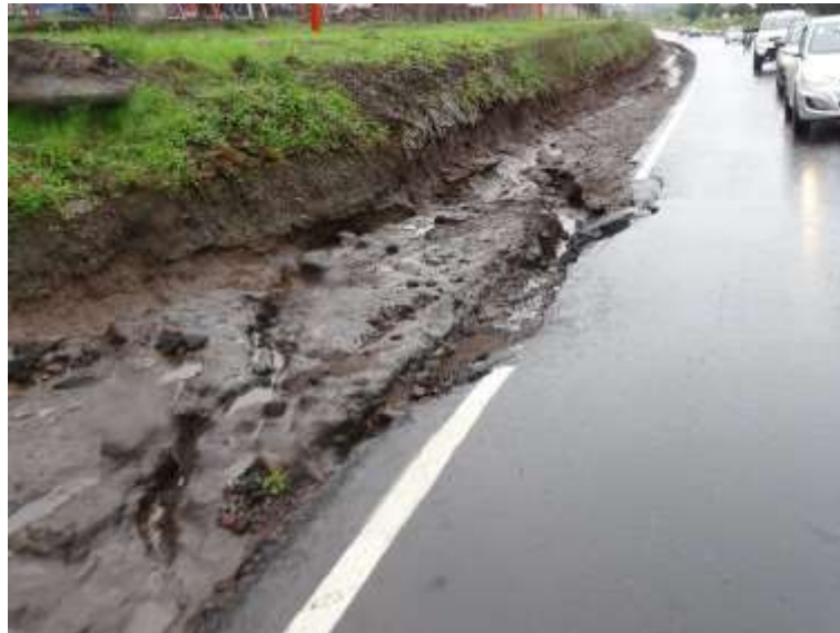
Figura 16. Deterioro en la capa de mezcla asfáltica producto de la socavación de las capas subyacentes y ausencia de confinamiento lateral, estacionamiento 2+360. Fecha: 23 de julio de 2021. Fuente LanammeUCR.
