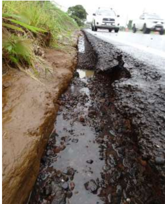
Figura 12. Ausencia de cunetas, que propició socavación y pérdidas de material de las capas granulares subyacentes del pavimento, estacionamiento 1+310. Fecha: 23 de julio de 2021. Fuente LanammeUCR.
