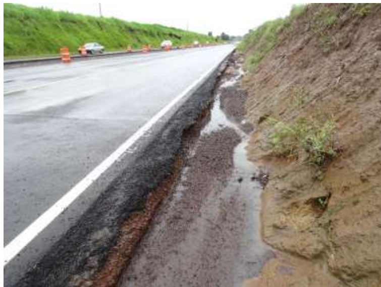
Figura 11. La ausencia de cunetas ha causado erosión en la margen lateral de la carretera afectando la estructura de pavimento recién construida, estacionamiento 1+260. Fecha: 23 de julio de 2021. Fuente LanammeUCR.
