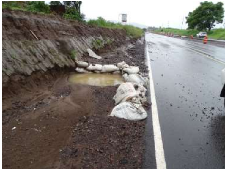
Figura 15. Acumulación de agua a un lado de la calzada y afectación del pie del talud, estacionamiento 1+820. Fecha: 23 de julio de 2021. Fuente LanammeUCR.
