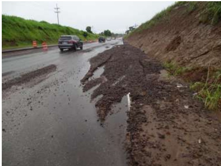
Figura 13. Acumulación de materiales granulares sobre la calzada que se convierte en un riesgo para los usuarios, estacionamiento 1+560. Fecha: 23 de julio de 2021. Fuente LanammeUCR.
