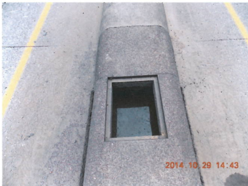
Figura 1. Ejemplo de desagüe obstruido en el acceso sureste.
