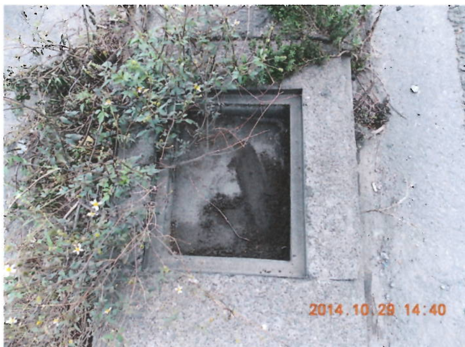
Figura 3. Desagüe en el punto más bajo del acceso suroeste obstruido con maleza y sedimentos.
