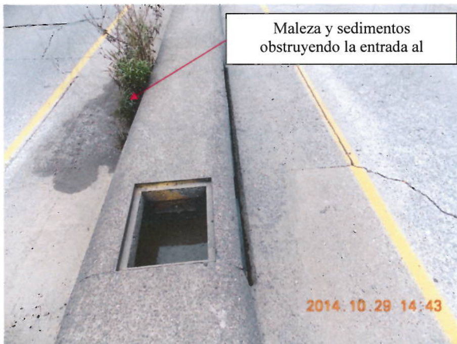
Figura 2. Obstrucciones en la entrada al sistema de drenaje del puente.
