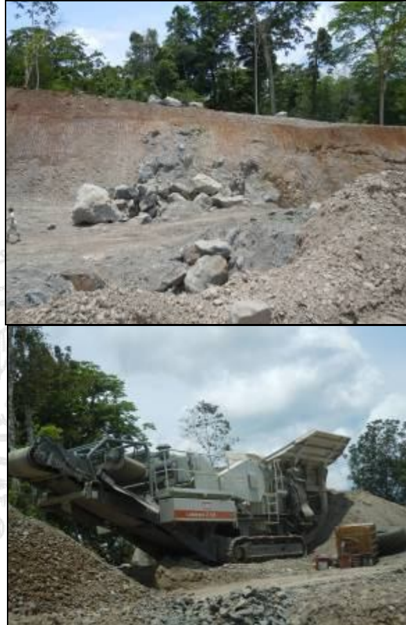
Figura 37. Tajo ubicado cerca de Tiricias, tramo 8 Fuente: LanammeUCR, Mayo 2012.
