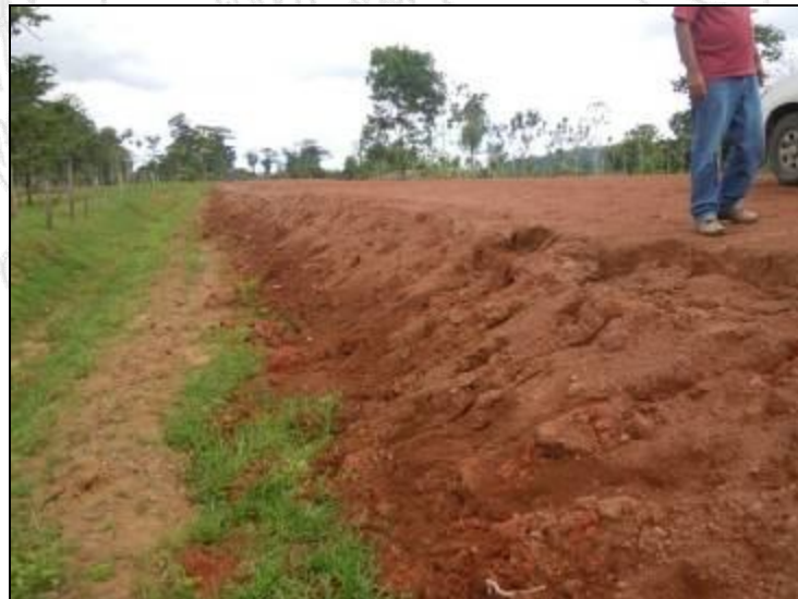
Figura 15. Relleno con evidencia de desprendimientos en la plataforma tramo 3. Fuente: LanammeUCR, Mayo 2012.
