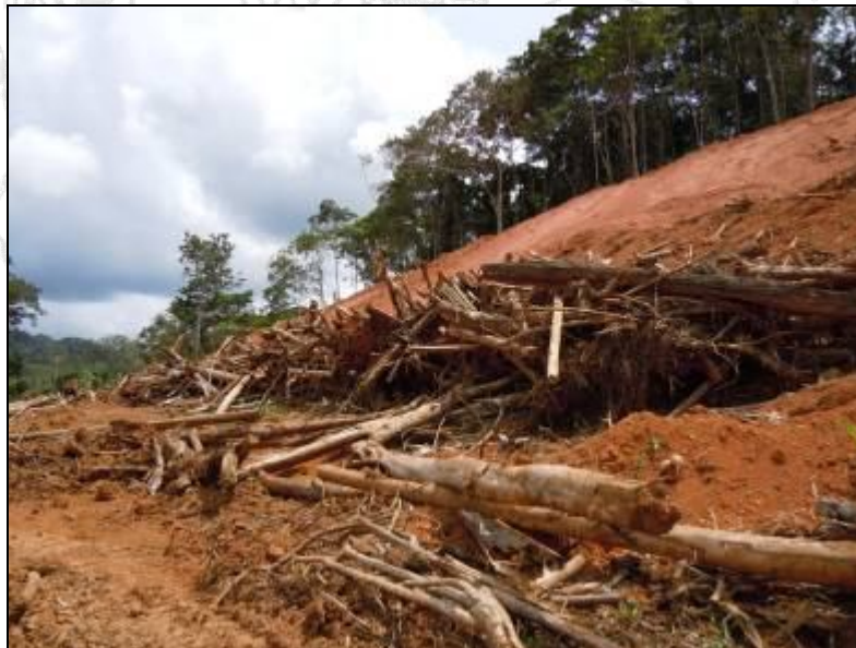
Figura 29. Maleza y troncos colocados al pie de un talud, tramo 6. Fuente: LanammeUCR, Mayo 2012.
