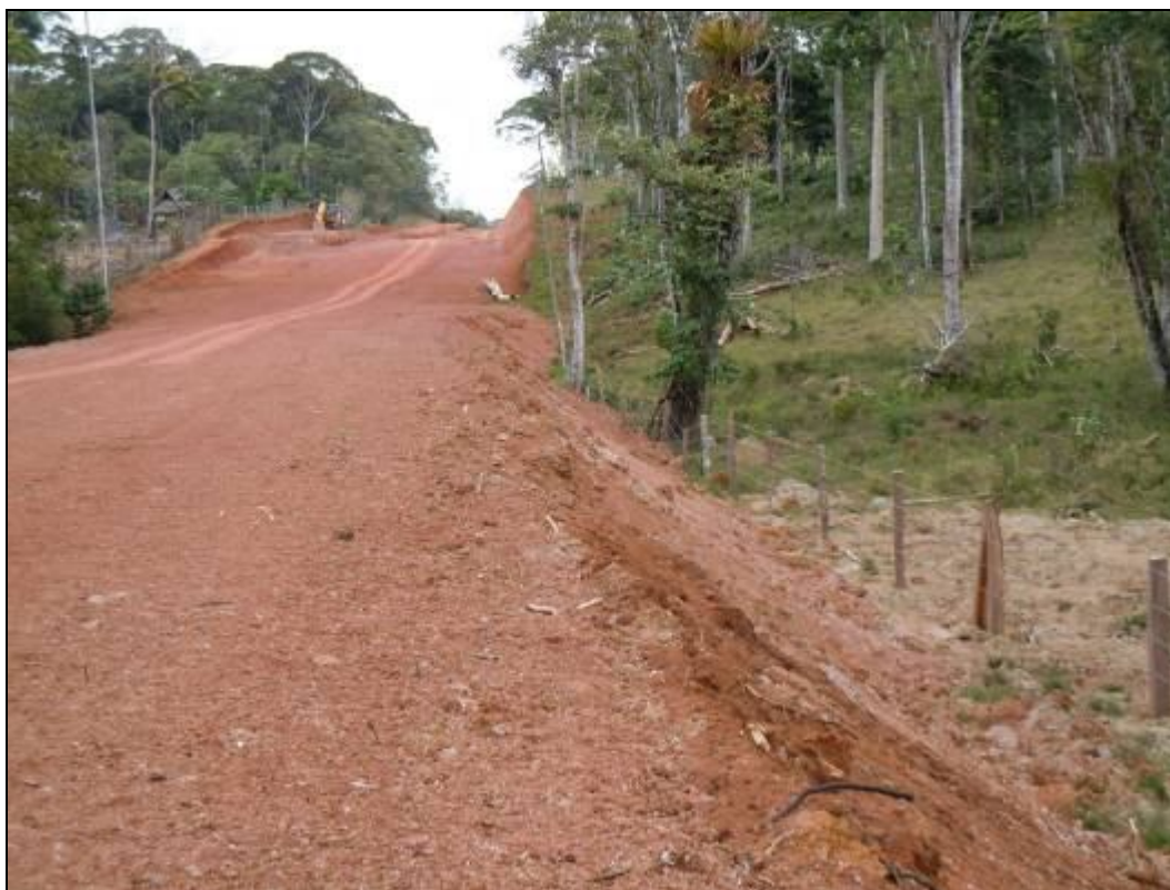
Figura 47. Zonas de relleno no cuentan con obras de drenaje. Fuente: LanammeUCR, Mayo 2012.
