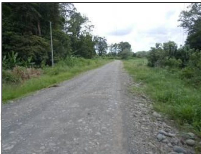
Figura 3. Condición de la corona tramo 1. Fuente: LanammeUCR, Mayo 2012.
