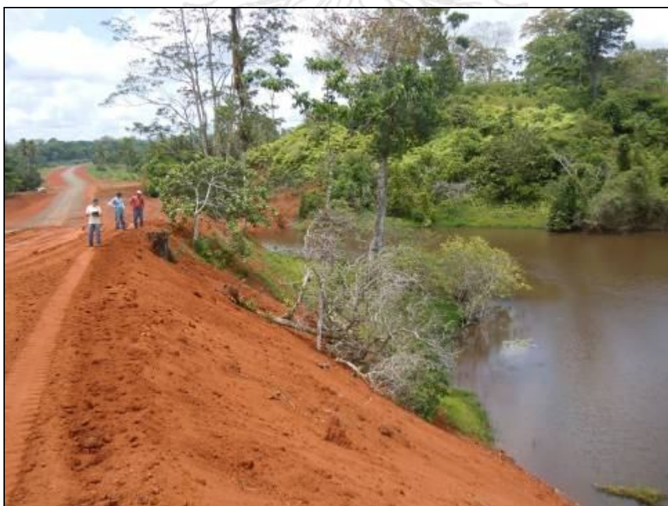
Figura 21. Inadecuado manejo del material de corte y talud. Fuente: LanammeUCR, Mayo 2012.
