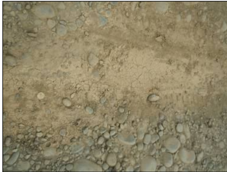
Figura 8. Huecos y material contaminado con la subrasante. Fuente: LanammeUCR, Mayo 2012.
