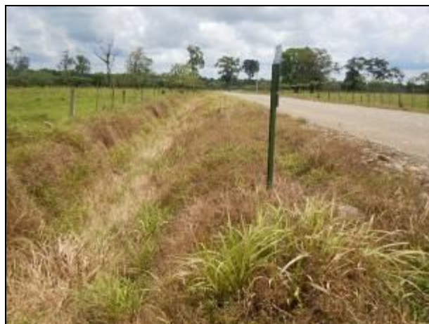
Figura 4. Condición de las cunetas en tramo 1. Fuente: LanammeUCR, Mayo 2012.
