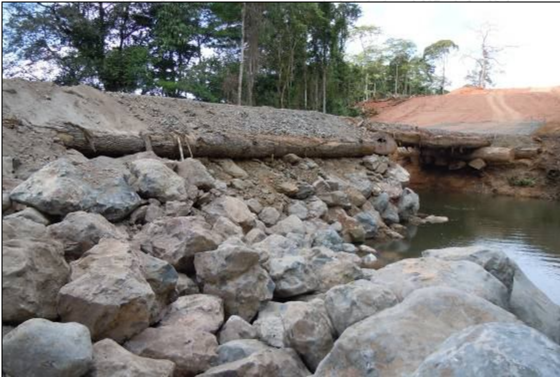
Figura 32. Puente de troncos sobre el Río Infiernito. Reducción del área hidráulica. Fuente: LanammeUCR, Mayo 2012.
