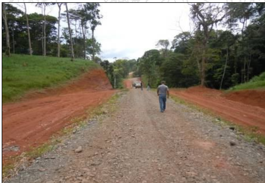
Figura 12. Ausencia de estructuras de drenaje laterales. Fuente: LanammeUCR, Mayo 2012.
