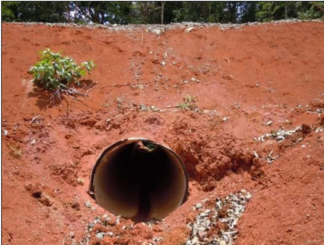
Figura 45. Tuberías tipo Rib-Loc instaladas incorrectamente. Fuente: LanammeUCR, Mayo 2012.
