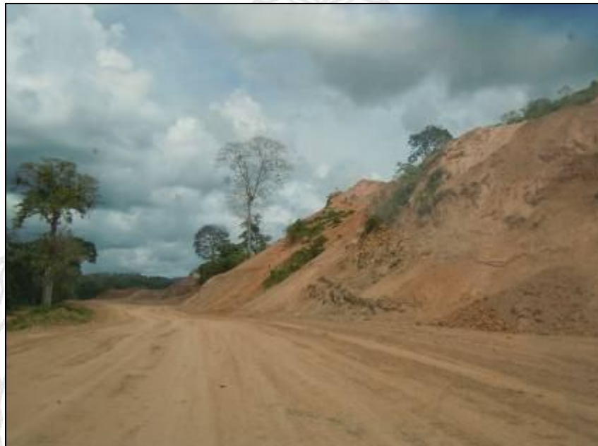
Figura 27. Talud de corte inestable, tramo 6. Fuente: LanammeUCR, Mayo 2012.
