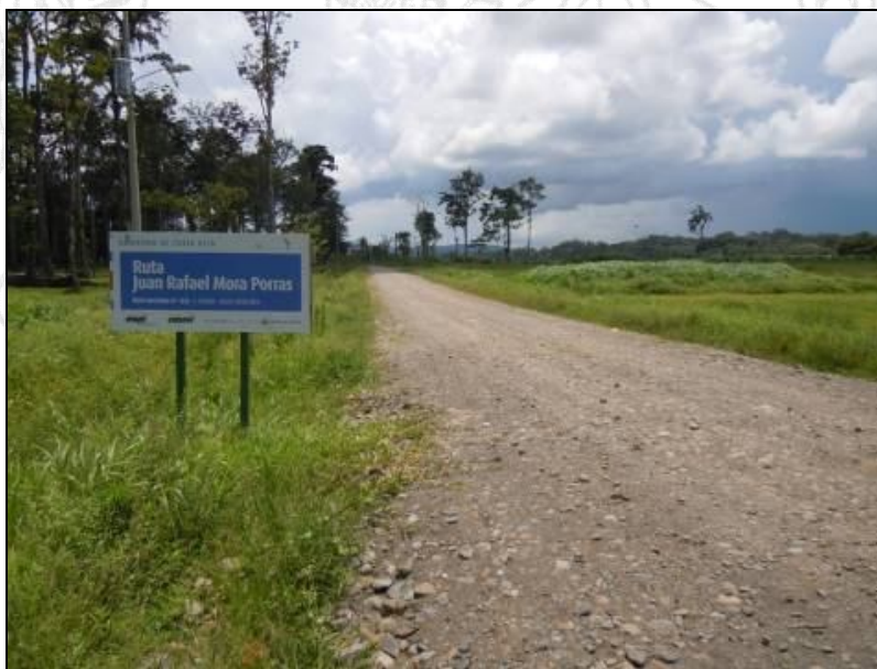
Figura 2. Estado de la plataforma en el tramo 1. Fuente: LanammeUCR, Mayo 2012.
