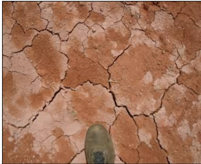
Figura 14. Agrietamiento del suelo, tramo 3. Fuente: LanammeUCR, Mayo 2012.
