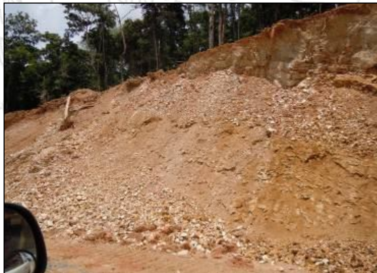
Figura 42. Taludes deslizados en zonas de corte, tramo 8 Fuente: LanammeUCR, Mayo 2012.
