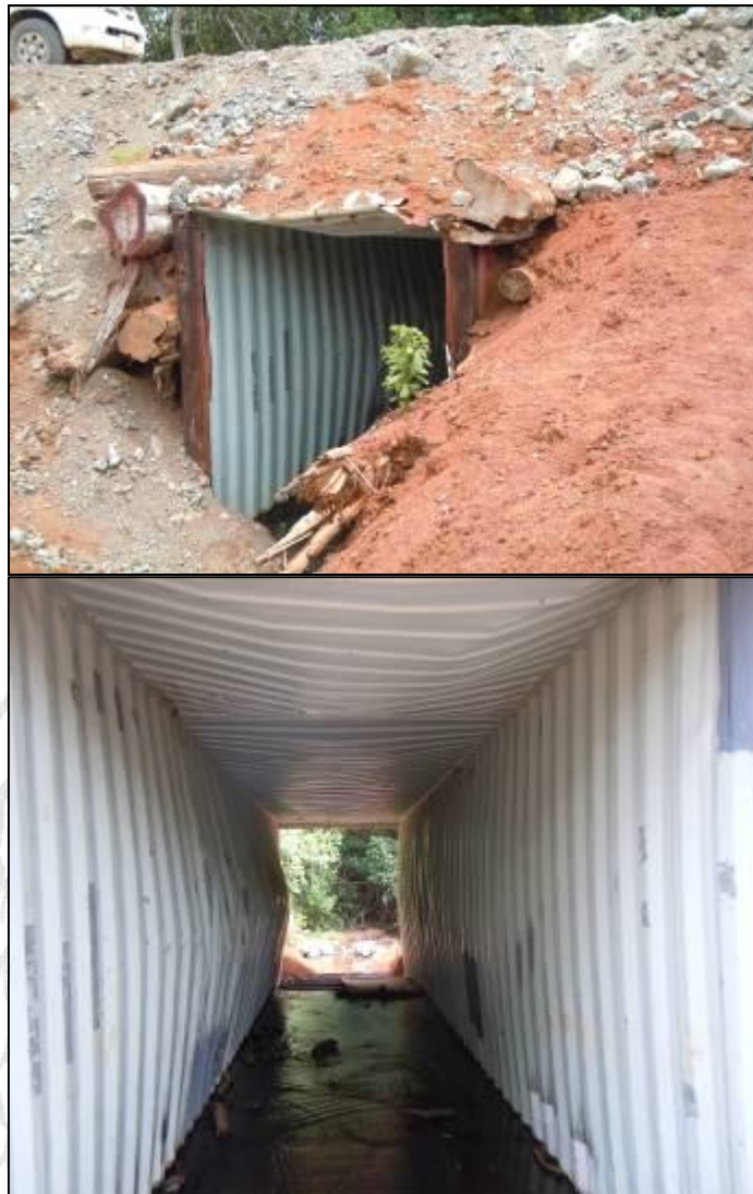
Figura 46. Contenedores utilizados como alcantarillas de cuadro. Fuente: LanammeUCR, Mayo 2012.
