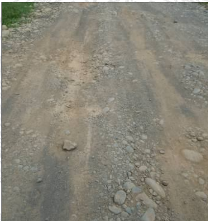
Figura 7. Deformaciones y material granular contaminado. Fuente: LanammeUCR, Mayo 2012.
