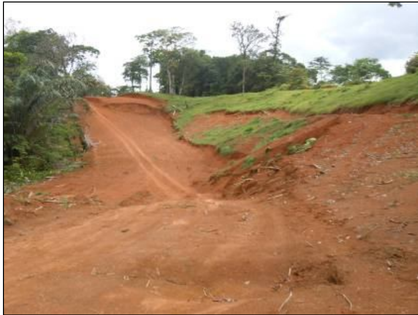
Figura 18. Deslizamientos en la Ruta, tramo 4. Fuente: LanammeUCR, Mayo 2012.
