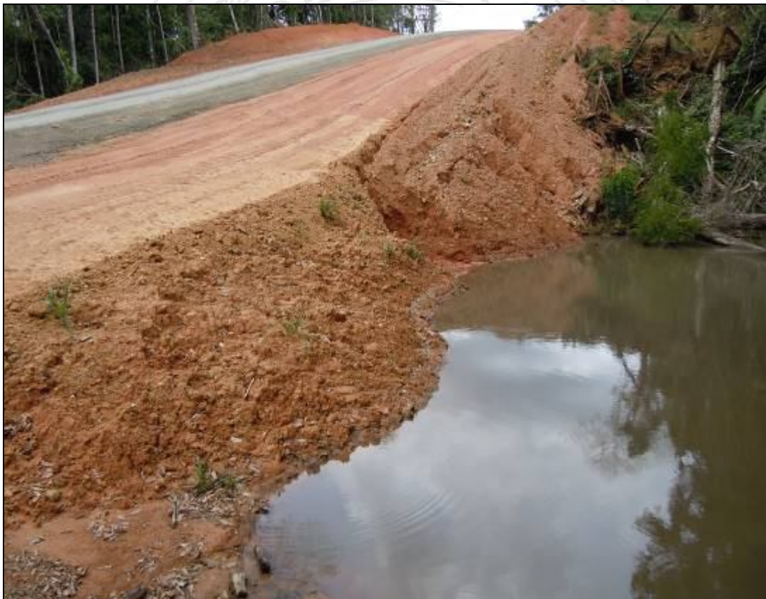
Figura 33. Obstrucción de cuerpos de agua. Fuente: LanammeUCR, Mayo 2012.
