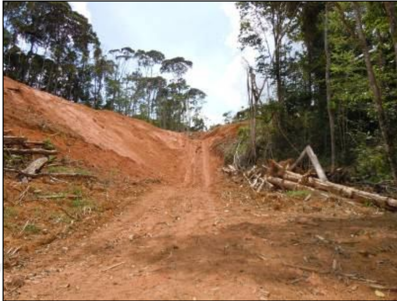
Figura 28. Zona de rellenos, tramo 6. Fuente: LanammeUCR, Mayo 2012.
