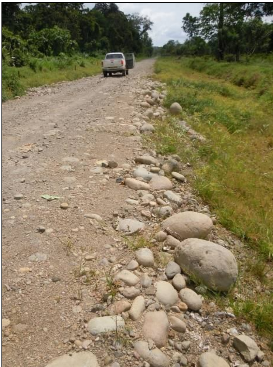
Figura 9. Condición actual de la plataforma, tramo 2. Fuente: LanammeUCR, Mayo 2012.
